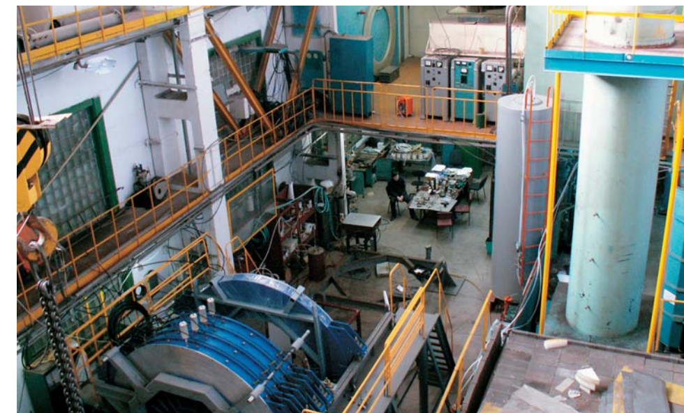
Мощные современные импульсные генераторы в высоковольтном зале
